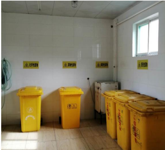
医疗废物暂存室
