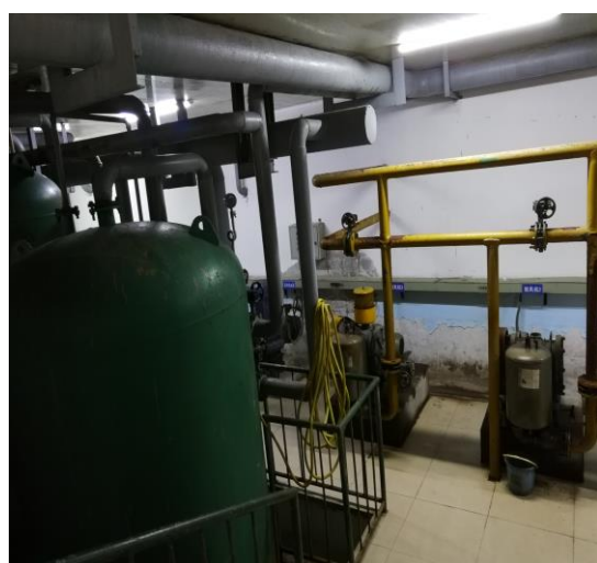
污水处理设施
